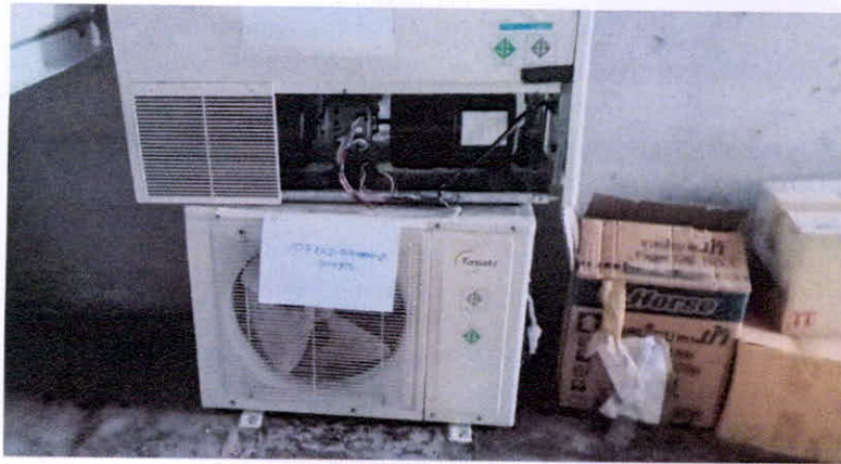
29. เครื่องปรับอากาศ หมายเลขครุภัณฑ์ 107202-06710000-002
