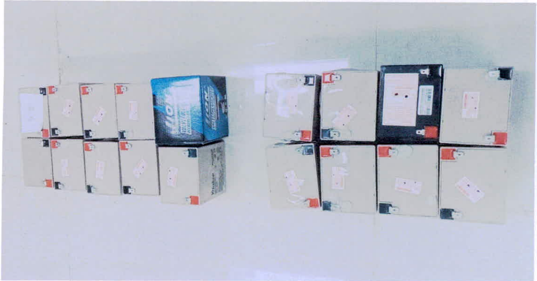
51. แบตเตอรี่เครื่องสำรองไฟก้อนใหญ่ จำนวน 18 ก้อน
