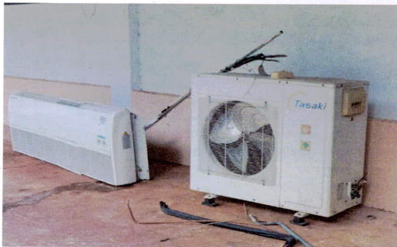
34. เครื่องปรับอากาศ หมายเลขครุภัณฑ์ 107220-06710070-001
