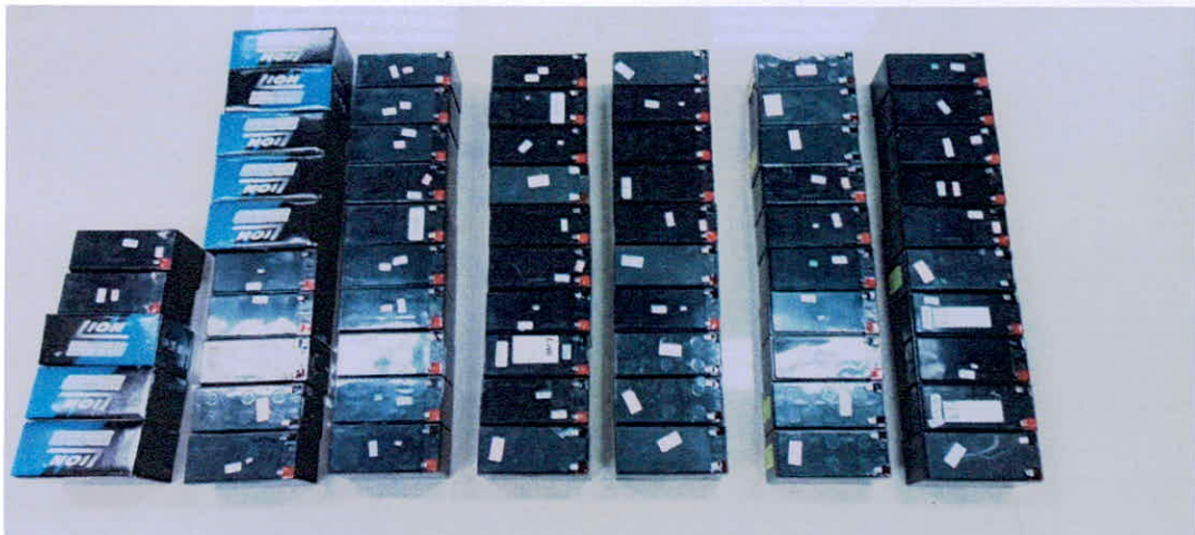
52. แบตเตอรี่เครื่องสำรองไฟก้อนเล็กจำนวน 125 ลูก
